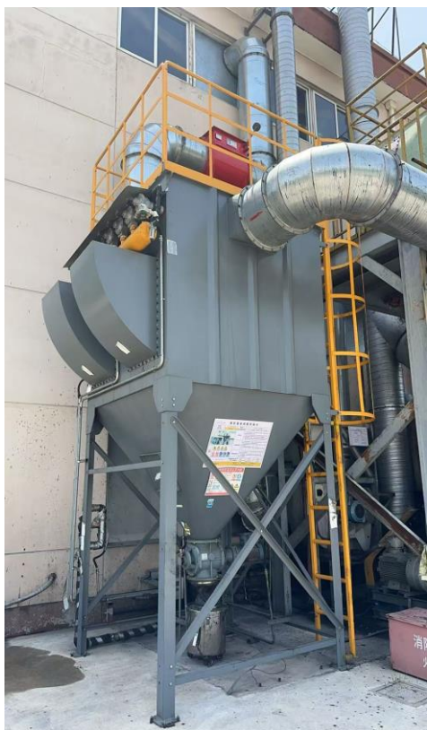
脉冲滤筒除尘器 1#
