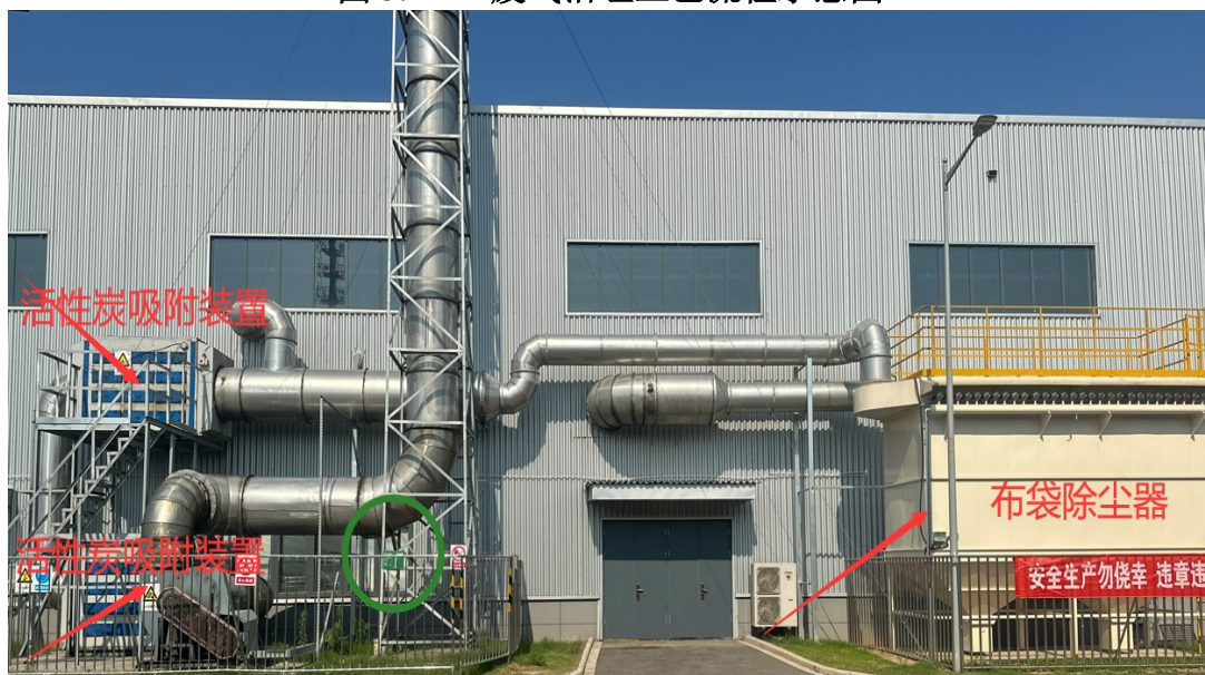
图 3.2-2 废气治理设施现状图（组件厂房一、布袋除尘器+二级活性炭吸附装置（DA001））
