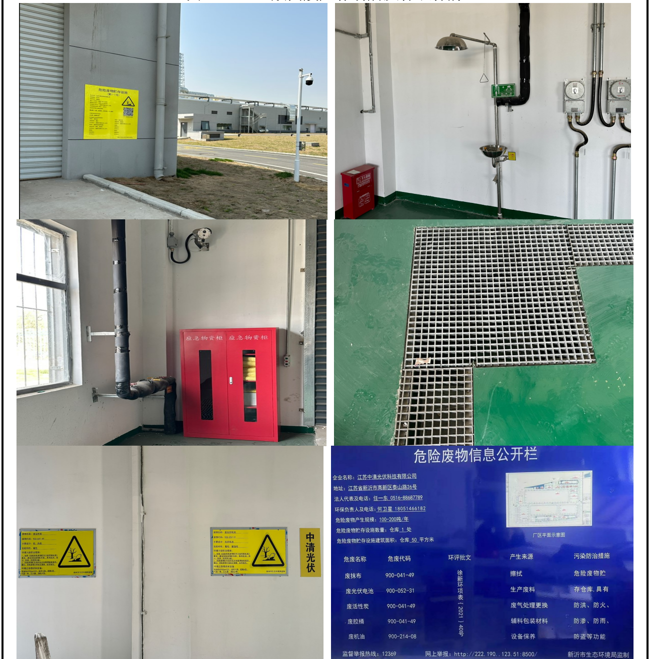
图 3.4-2 危险废物贮存场所及标识标牌
