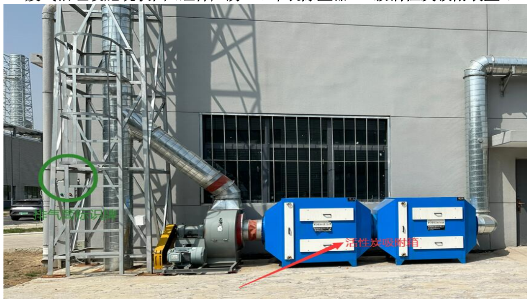
图 3.2-3 废气治理设施现状图（危废仓库、二级活性炭吸附装置（DA004））
