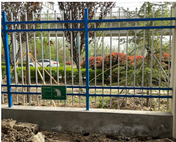
图 3.1-3 污水排口现状照片图
