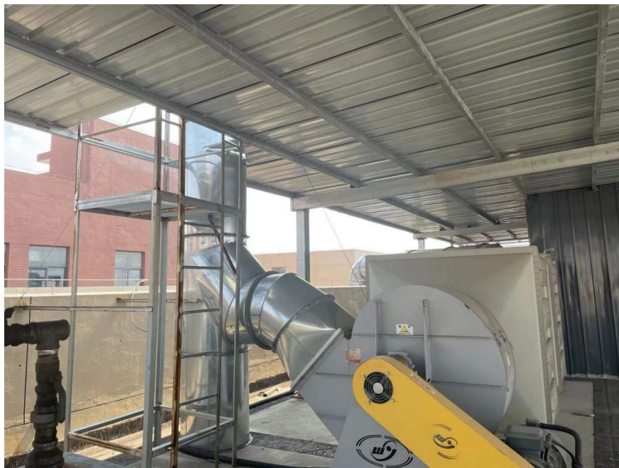
图3-3 活性炭吸附装置现场照片
