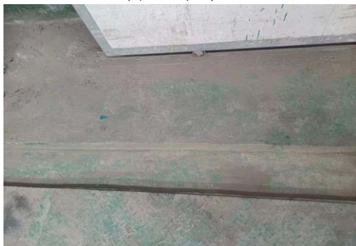
图 4-7 废电池堆放区导流沟
