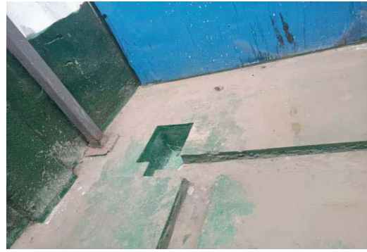
图 4-11 其他危废暂存区导流沟
