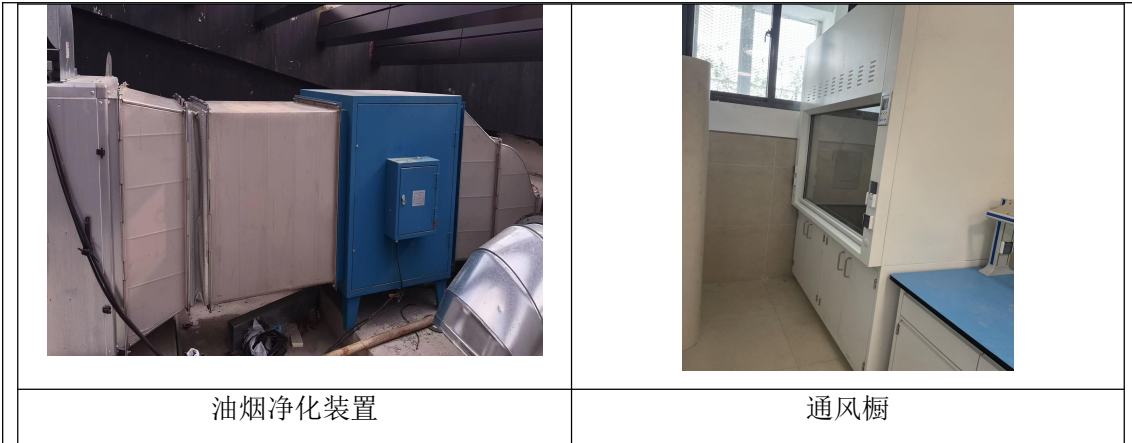
图 3-2 废气处理设施
